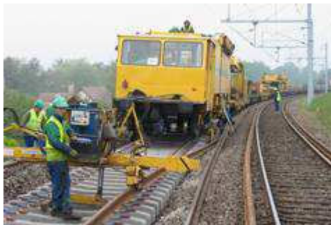
Longs Rails soudés sur traverses béton
