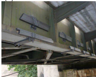
absorbeur sur platelage
